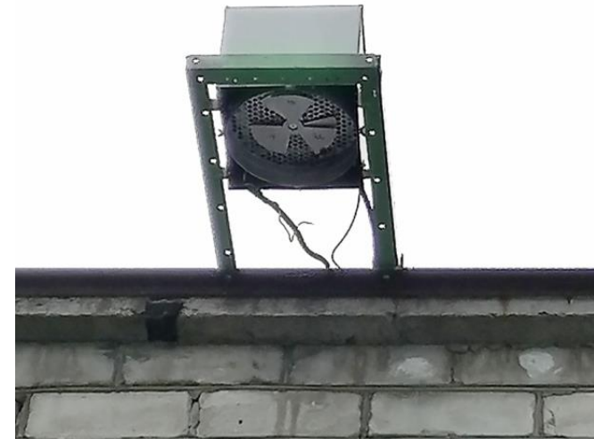
Рис.3 – Электростатический флюксометр на здании ИПРЭК СО РАН (г. Чита)
